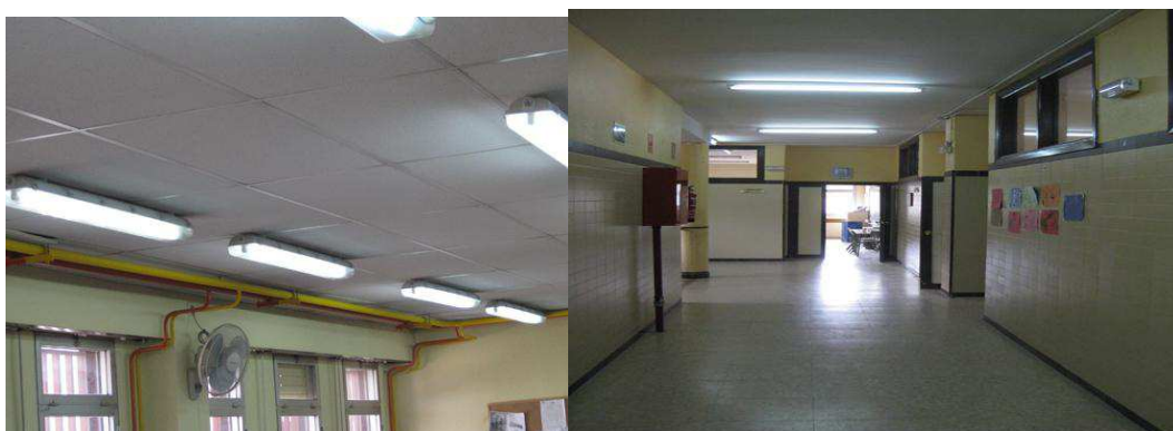
Instalación de iluminación existente en los colegios del lote 3.
