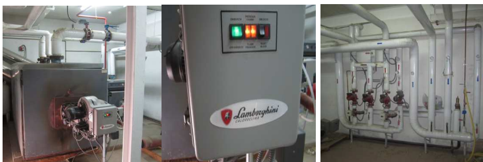
Instalaciones térmicas de colegios sujetas al plan de inversiones de la ESE.
