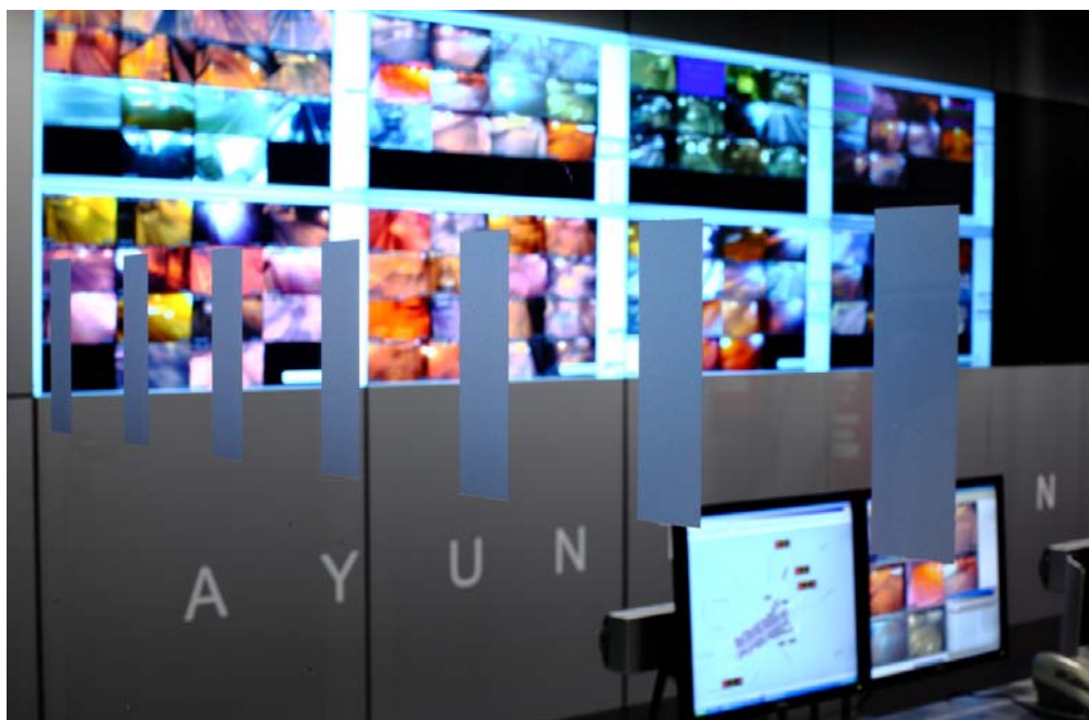
Centro de control de instalaciones de servicios de Madrid.
