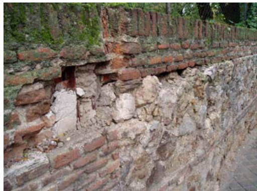
Fotografías que reflejan un punto donde el muro ya ha roto por su hoja exterior, con posibilidad de derrumbamiento
