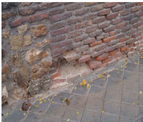
Más puntos del tramo con fuertes pérdidas de ladrillo en el zócalo inferior, ya sea de fábrica o piedra de mampostería, dejando ya bastante definido, a lo largo de las diferentes fotografías mostradas, que en este tramo descrito, la referenciada parte inferior del muro, es la mas castigada por el deterioro progresivo.
