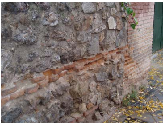
Zona previa a la primera puerta de acceso en Pº de la Alameda, junto al machón de la puerta, donde se observan pérdidas graves de material tanto en fábrica de ladrillo como en zócalo de piedra.
