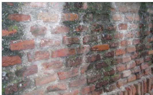
Alzado Sur, suciedad provocada por escorrentías verticales
