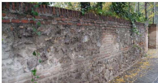
Alzado Sur, suciedad general del paramento, debido a que la rugosidad y porosidad de la estructura que lo forma, facilitan su acumulación.
