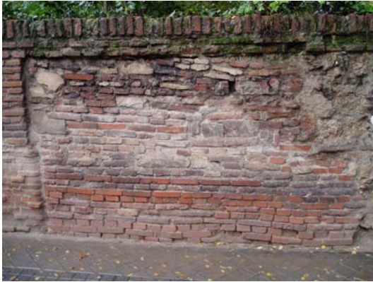
Zona del tramo en la que se observan posteriores rehabilitaciones al original, pero sin mantener ni tipología ni materiales adecuados. En este caso incluso se ha utilizado ladrillo donde originalmente existía casetón de mampostería de piedra.
