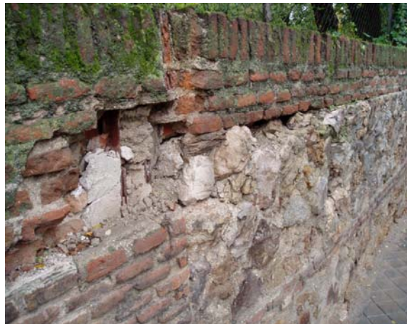
Tercera zona del tramo con desplomes, y en este caso rotura de la hoja exterior del muro, la cual habrá que reconstruir de forma integral.
