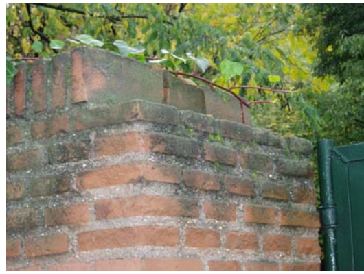
Pérdidas de material en el sardinel de remate de una de las mochetas que forman la estructura del hueco de acceso al Jardín por el Pº de la Alameda, previo a Casa de Vacas.
