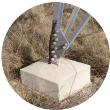
Puesta a tierra de la torre
