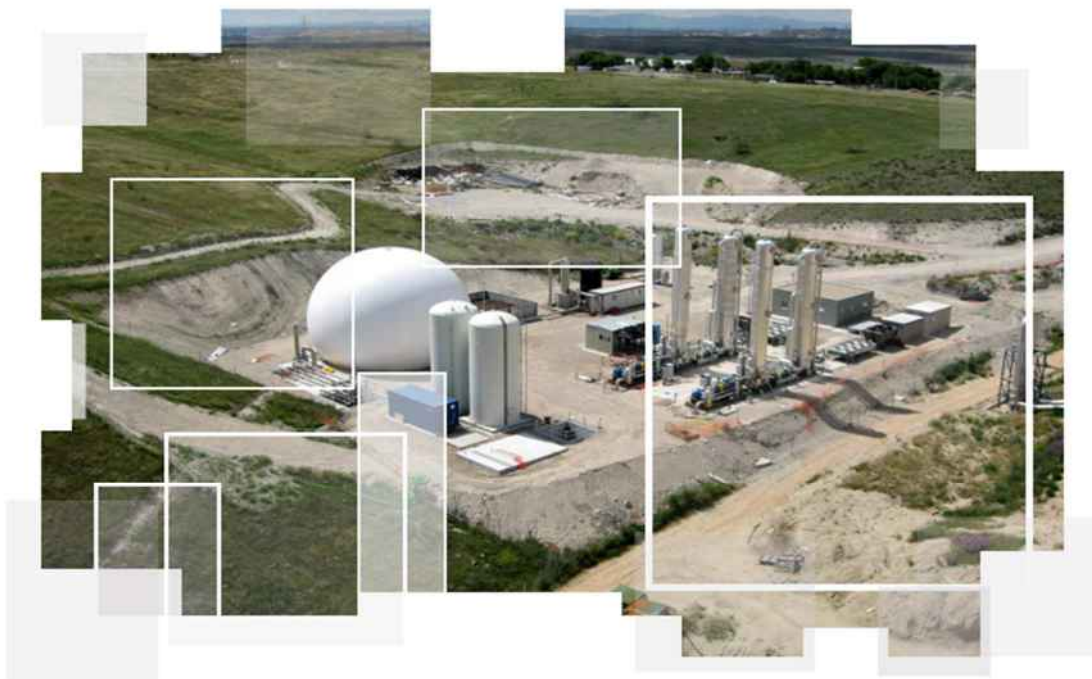
Figura 7.3 Planta de tratamiento de biogas del P.T.V.
