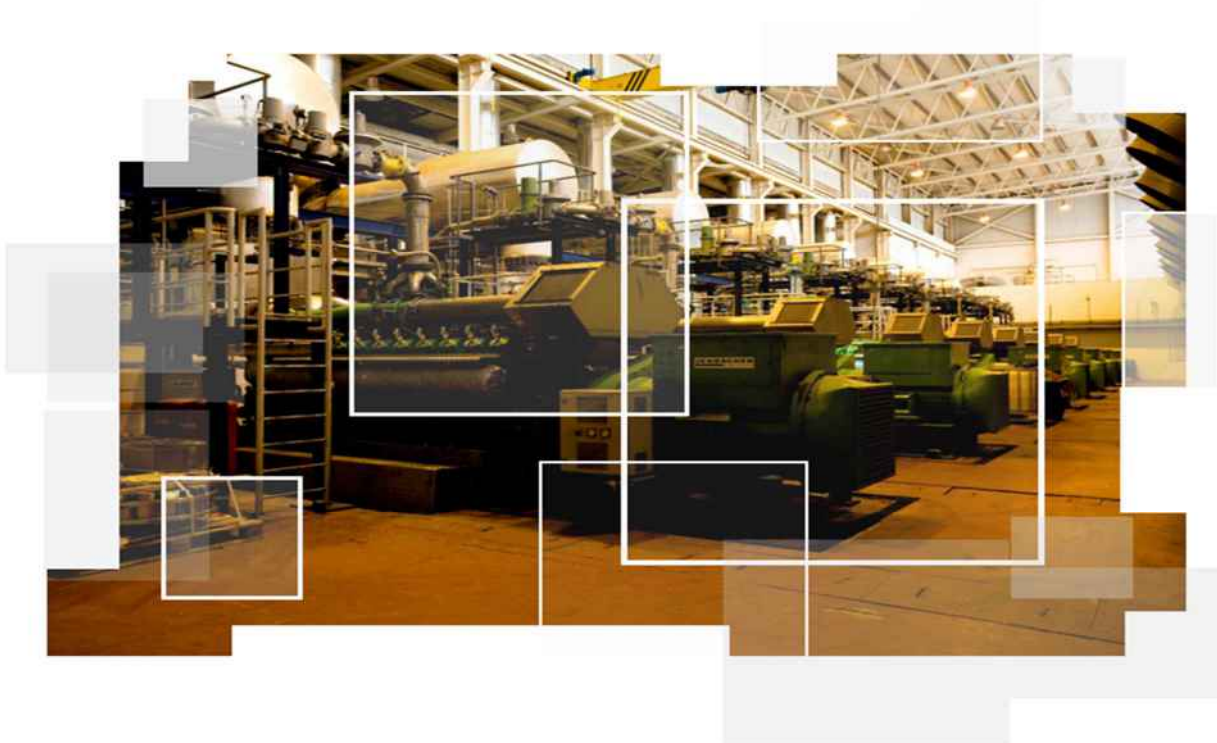
Foto 6.1. Grupos moto-generadores de la planta de La Galiana.
