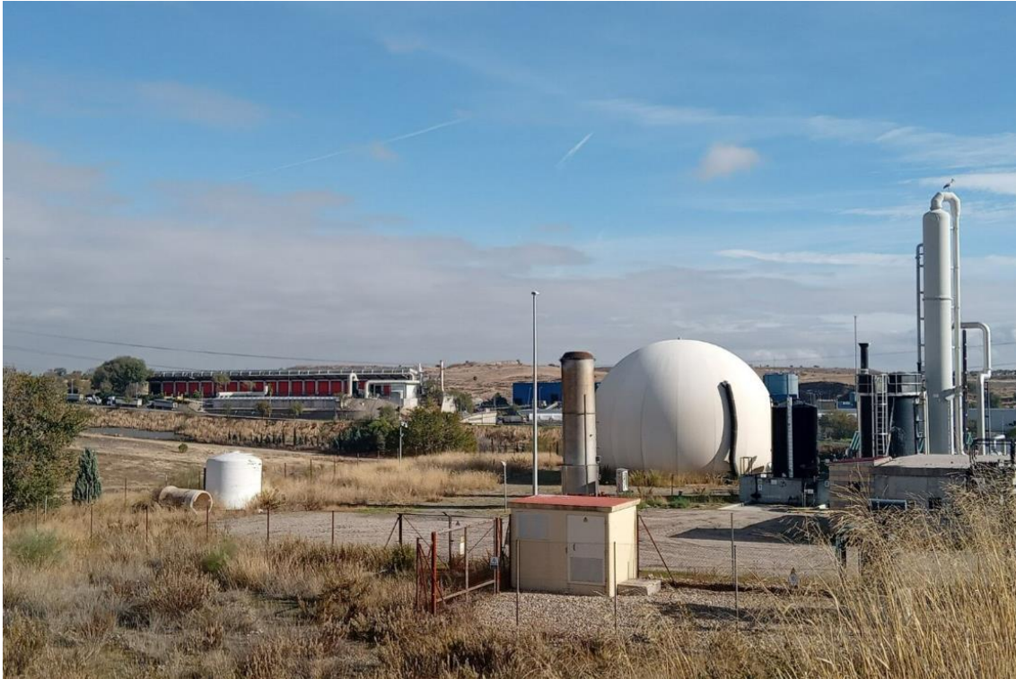
Zona de desgasificación y lavado de biogás de vertedero
