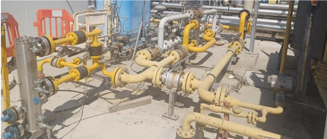
Punto de inyección de biometano hacia la estación de medida y punto de interconexión de Enagás
