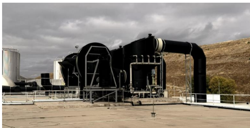
Nuevos sistemas de biofiltración
