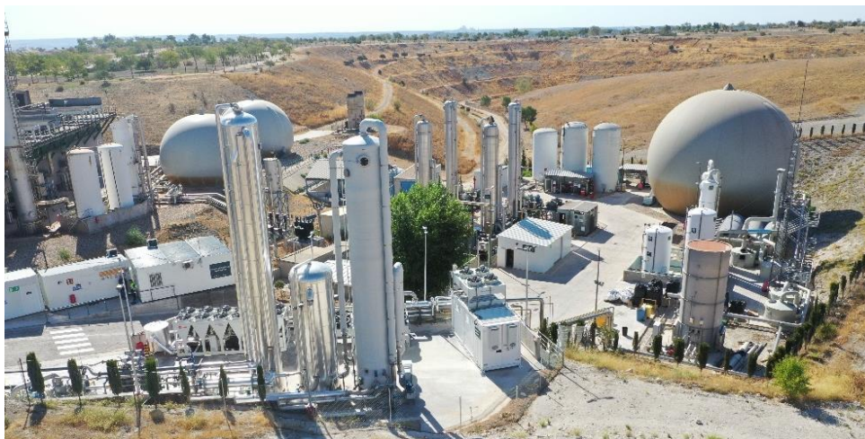
Planta de tratamiento de biogás (PTB)
