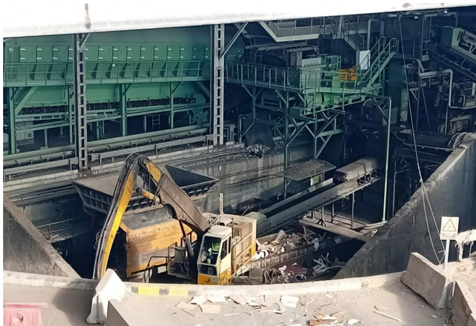
Área de tratamiento de residuos voluminosos
