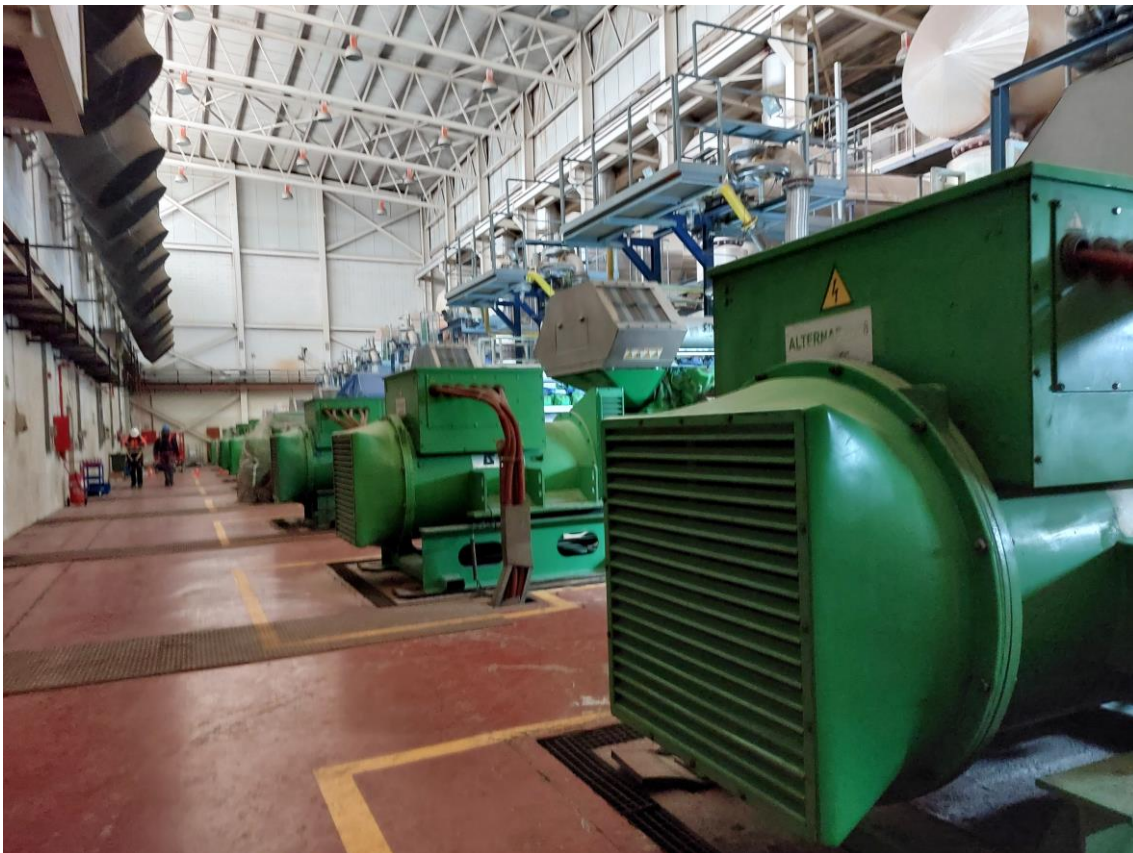
Sala de motores del centro de desgasificación y generación eléctrica "La Galiana"
