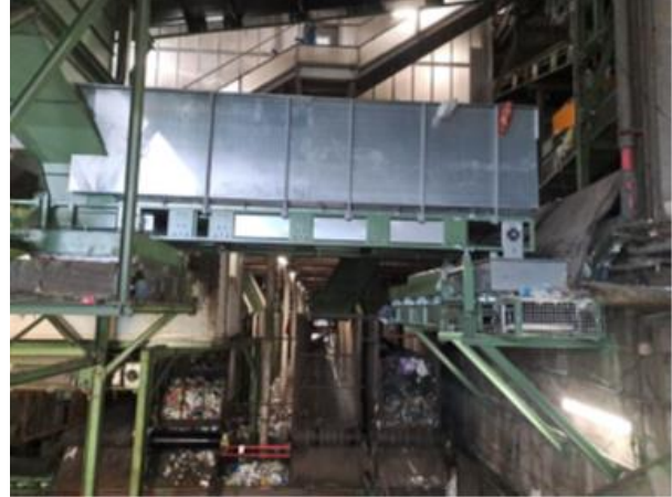
Equipo de separación de film instalado sobre estructura existente
