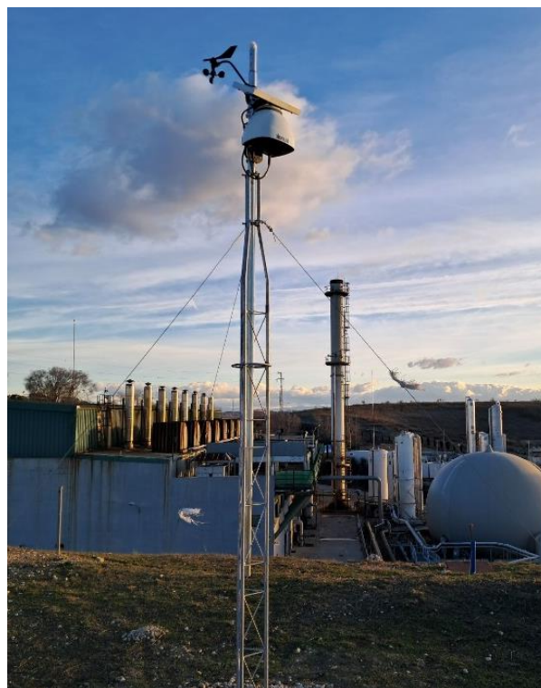
Estación remota para detección de sustancias odoríferas
