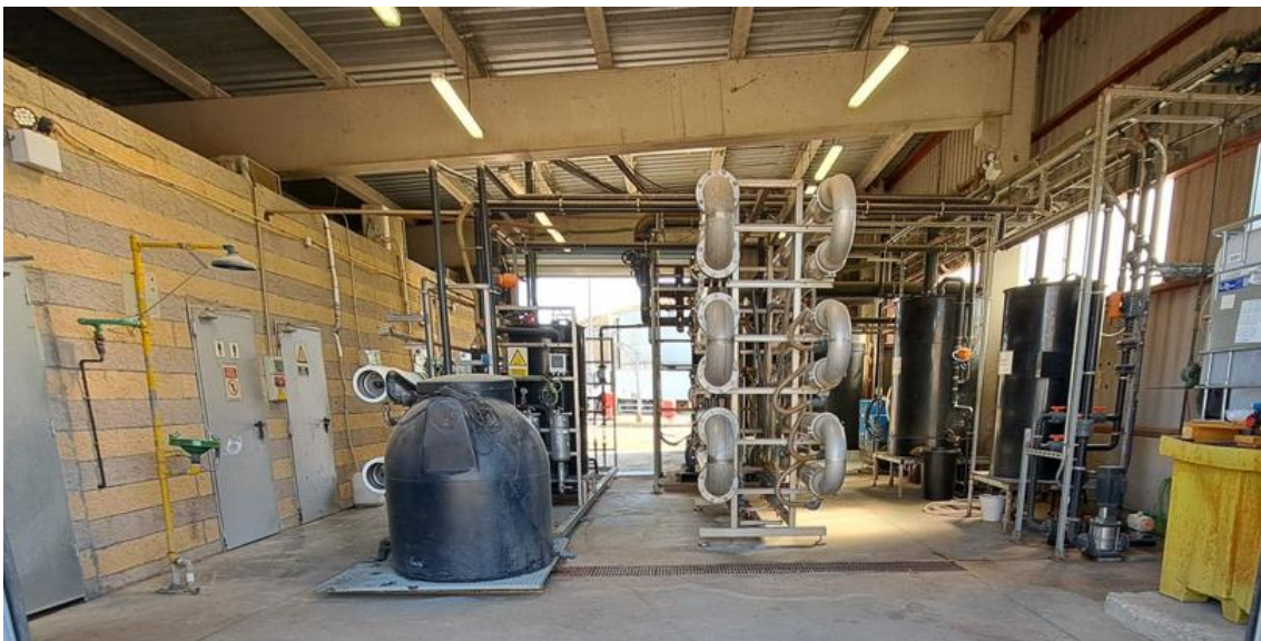
Planta de tratamiento de lixiviados y agua de proceso de la planta de biometanización Las Dehesas
