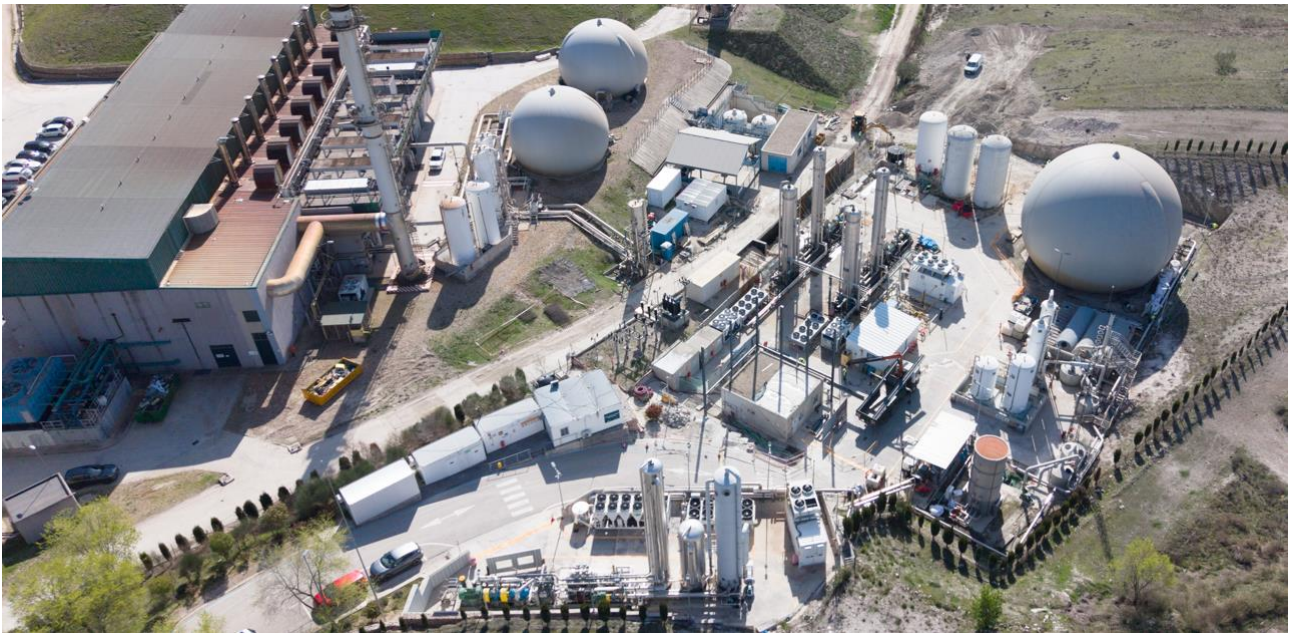
Planta de tratamiento de biogás (PTB) y de La Galiana
