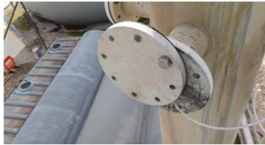
Muestreo de olores en los equipos de desulfuración de la PTB
