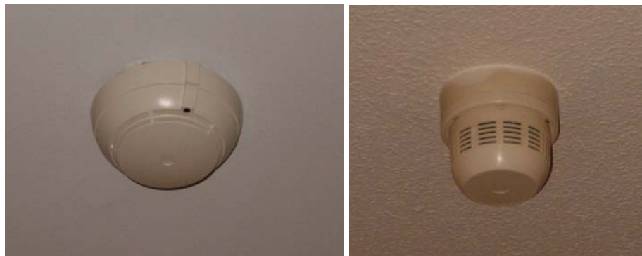
Detectores de seguridad (incendios).
