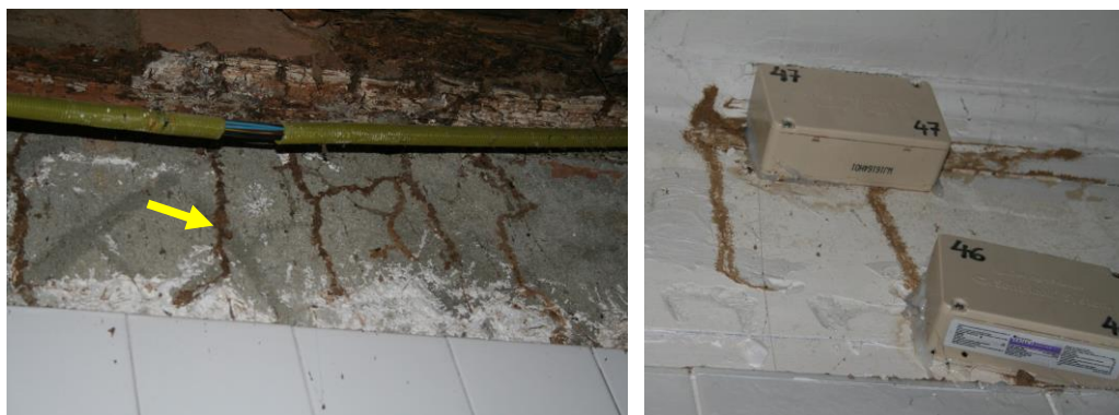
Túneles de progresión de las termitas. La fotografía derecha muestra estaciones de cebado (control biocida) instaladas (Fotografías DCV)
