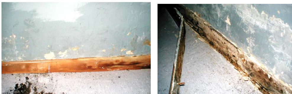
Humedad afectando a pared y rodapié. Este muestra importante infestación de termitas (Fotografías UTCV-Madrid Salud)
