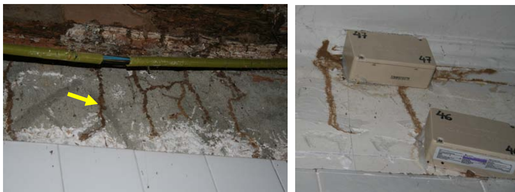
Túneles de progresión de las termitas. La fotografía derecha muestra estaciones de cebado (control biocida) instaladas (Fotografías UTCV-Salud Ambiental)
