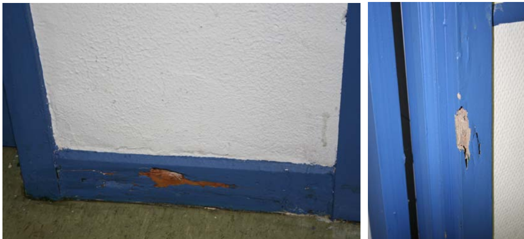
Daños en carpintería. La madera aparece con aspecto arrugado debido al deslaminado. Resulta friable y, en infestaciones activas, es posible ver actividad de los insectos (Fotografías UTCV-Salud Ambiental)
