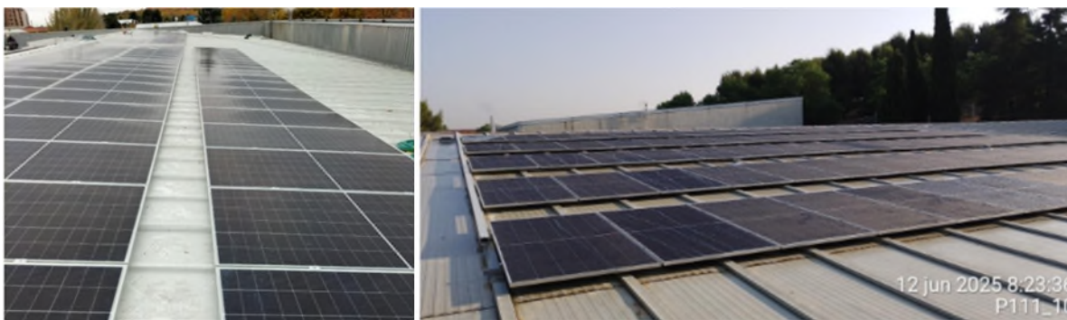
Instalaciones correspondientes a CDM Palomeras y CDM Cerro Almodóvar
