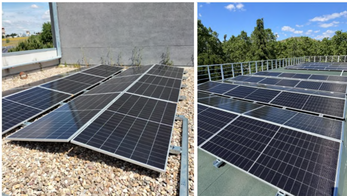
Instalaciones correspondientes a Puerta Abierta y Centro de Mayores Santa Eugenia
