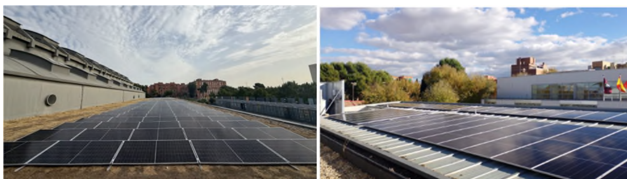
Instalaciones fotovoltaicas ejecutadas en La Nave y en el CM Lucero
