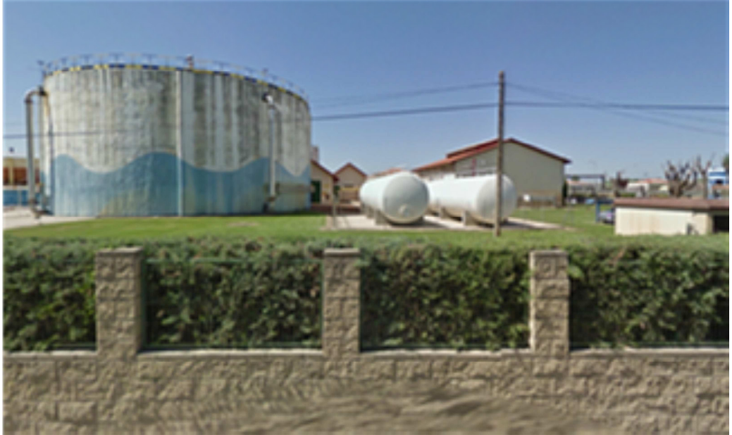
Imagen de las depuradoras que se encuentran en el ámbito, y manifiestan el grado de desarrollo de la actuación.
