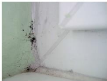
Imagen 1: Comienzo de aparición de moho en el punto de conexión de una ventana y una pared sin aislamiento
