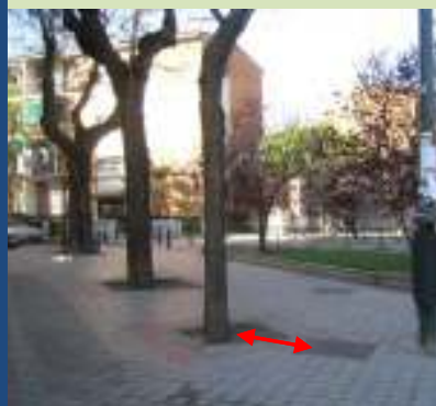
Foto: detalle de alcorque que no cumple la servidumbre mínima con la alcantarilla
